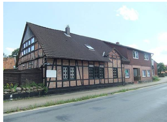
Frühere Modernisierungen mit unpassenden Formen und Materialien stören das Ortsbild.
